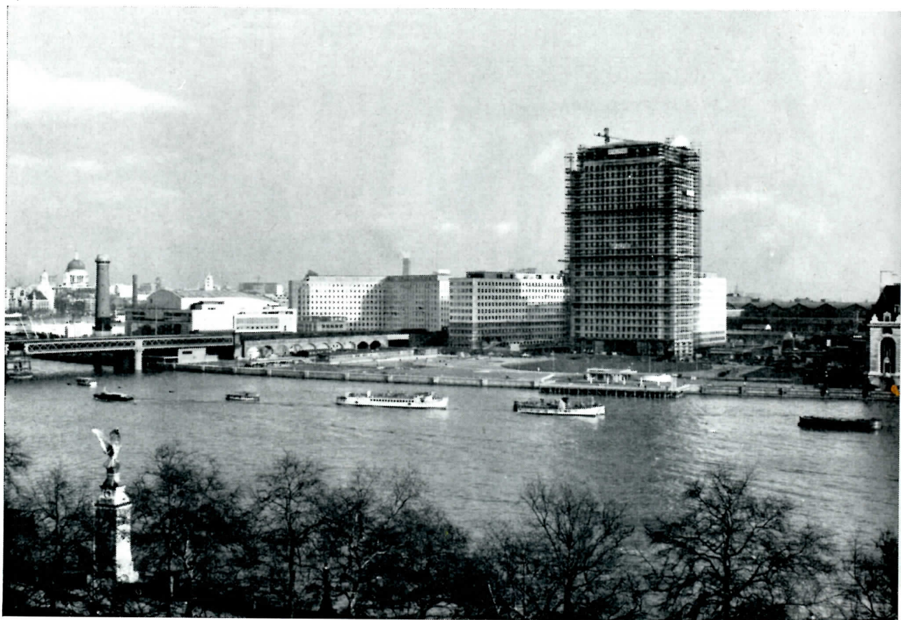
Het nieuwe Shell-kantoor in aanbouw aan de South Bank bij Waterloo Bridge in Londen
